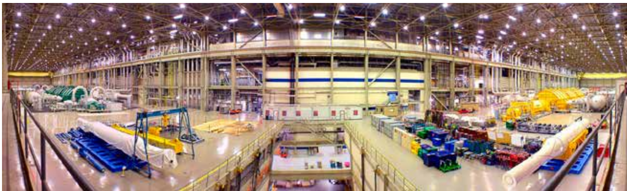
Fot. 2. Maszynownia elektrowni jądrowej Darlington (zezwoleń OPG 2007) Photo. 2. Darlington turbine hall (courtesy of OPG 2007)
