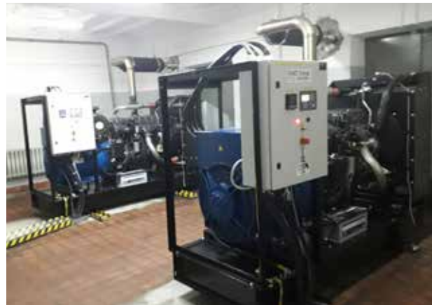
Fot. 1. Widok nowych awaryjnych agregatów Diesla
