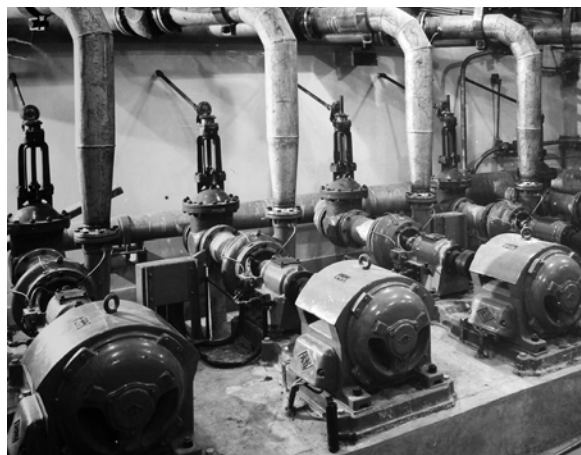
Pompownia obiegu pierwotnego
