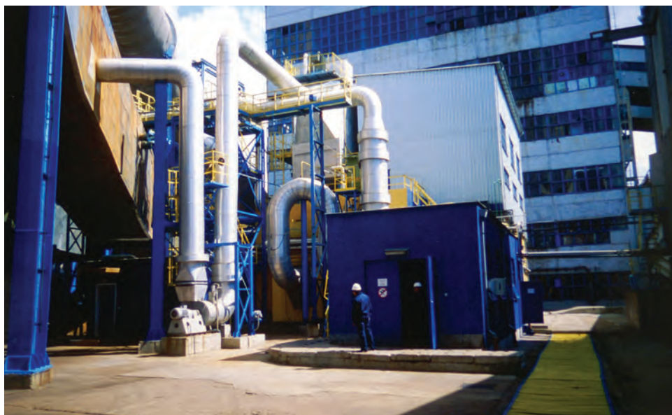
Fot.11. Stacja pilotowa oczyszczania gazów odlotowych w EC Maritze East w Bułgarii, w budowie i uruchomieniu której wzięli udział pracownicy IChTJ.
