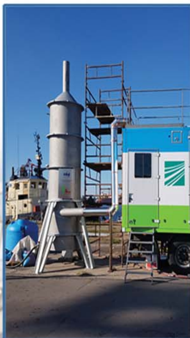
Instalacja pilotowa w Rydze
