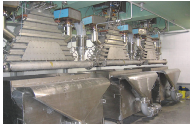
Fot. 3. Widok urządzeń wyjściowych akceleratora ELV 12 pracującego w instalacji do oczyszczania ścieków przemysłowych
